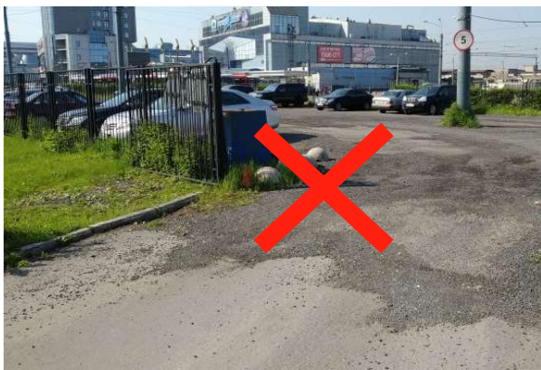
разрушение покрытия въезда-выезда
